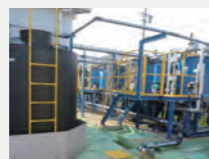
排水処理装置
