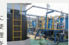
排水処理装置
