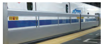
新大阪駅20番線可動式ホーム柵
