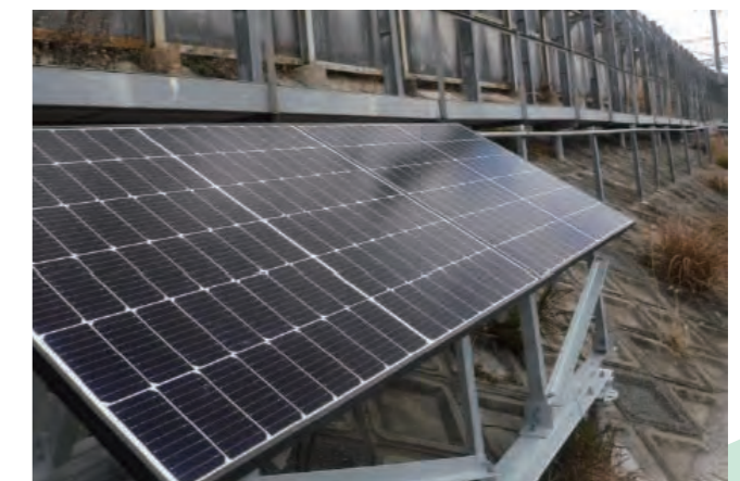
新幹線ののり面を活用した太陽光発電(試験設置)
