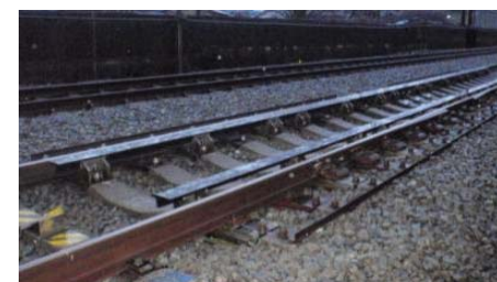
脱線防止ガード(伸縮継目部)
