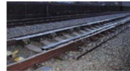
脱線防止ガード(伸縮継目部)
