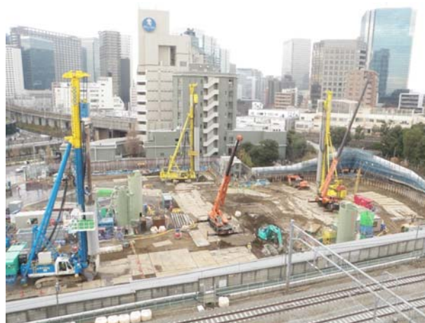
北品川非常口及び変電施設
